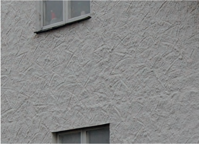
Den särpräglade falkenbergsputsen har en relativt grov struktur. Inom denna tradition har därtill de olika murarna haft sin egen variant.
