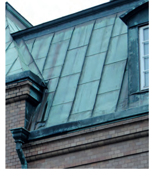
Vid omläggning av plåttak är det viktigt att behålla det gamla detaljutförandet. Skivtäckta kopparplåt, Kyrkans hus, före detta tingshuset.
